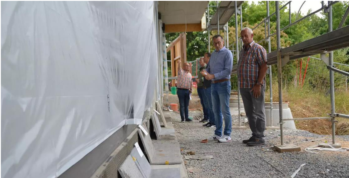
Foto: Sabine Eckert | Für die Erweiterung des Kindergartens in Urspringen traf sich der Gemeinderat zu einem Ortstermin an der Baustelle. Hier erfolgte die Bemusterung der Natursteine. Auch die Muster für die Putzfassade wurden vorgestellt.
