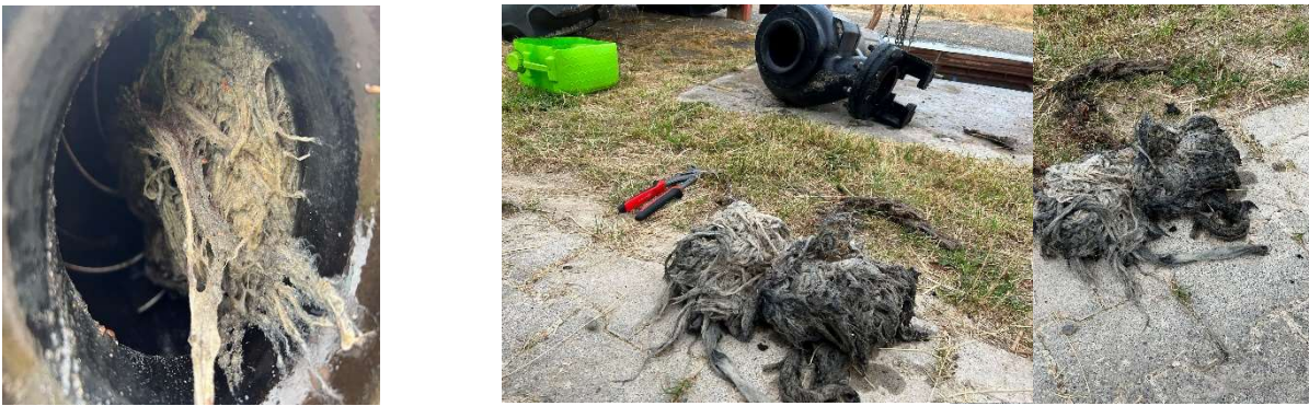
Originalbilder von den Abwasserpumpen der Kläranlage Urspringen (Verzopfungen)
